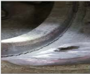
Casing Rib 손상
