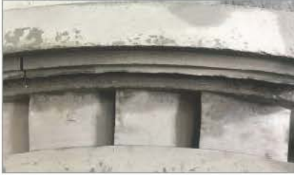
Spill Strip 손상
